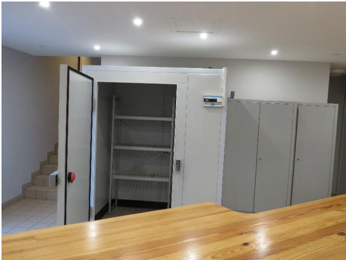
La chambre froide
